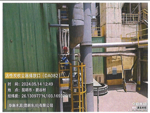
DA082 活性炭吸附除尘器排放口 (FQ16#)
