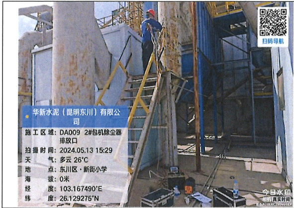
DA009 2#包机除尘器排放口 (FQ07#)
