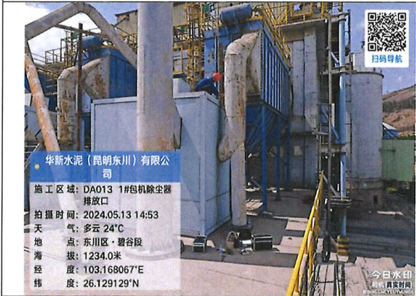
DA013 1#包机除尘器排放口 (FQ09#)
