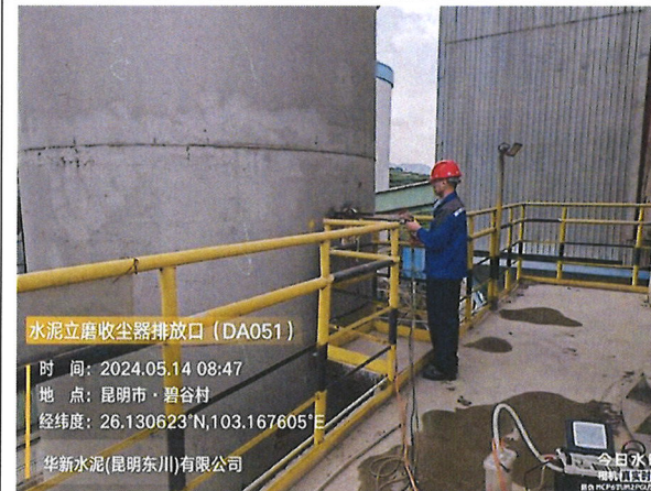
DA051 水泥立磨除尘器排放口 (FQ11#)
