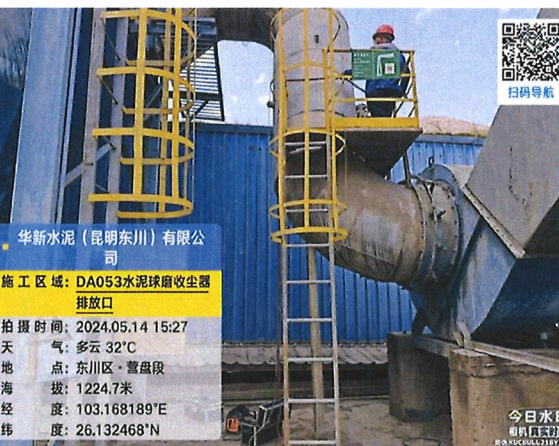
DA053 水泥球磨除尘器排放口 (FQ12#)
